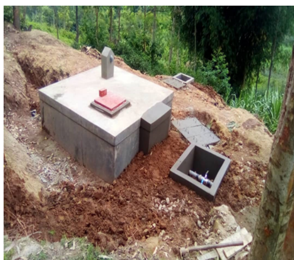
Depósito de 5 m3
